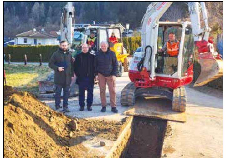
Mit Bauleiter Markus Kuchling von der Firma DPB, die die Erbauarbeiten durchführt, wurde unsere erste "Glasfaser-Baustelle" in Überfeld besichtigt.
