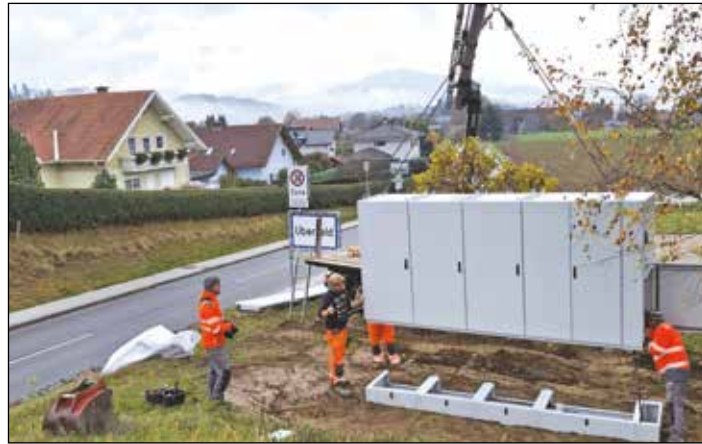
Der "Verteilerkasten" für Glasfaser in der Gemeinde Frauenstein wurde im Kreuzungsbereich der Überfelder und Wimitzer Landesstraße bereits errichtet.
